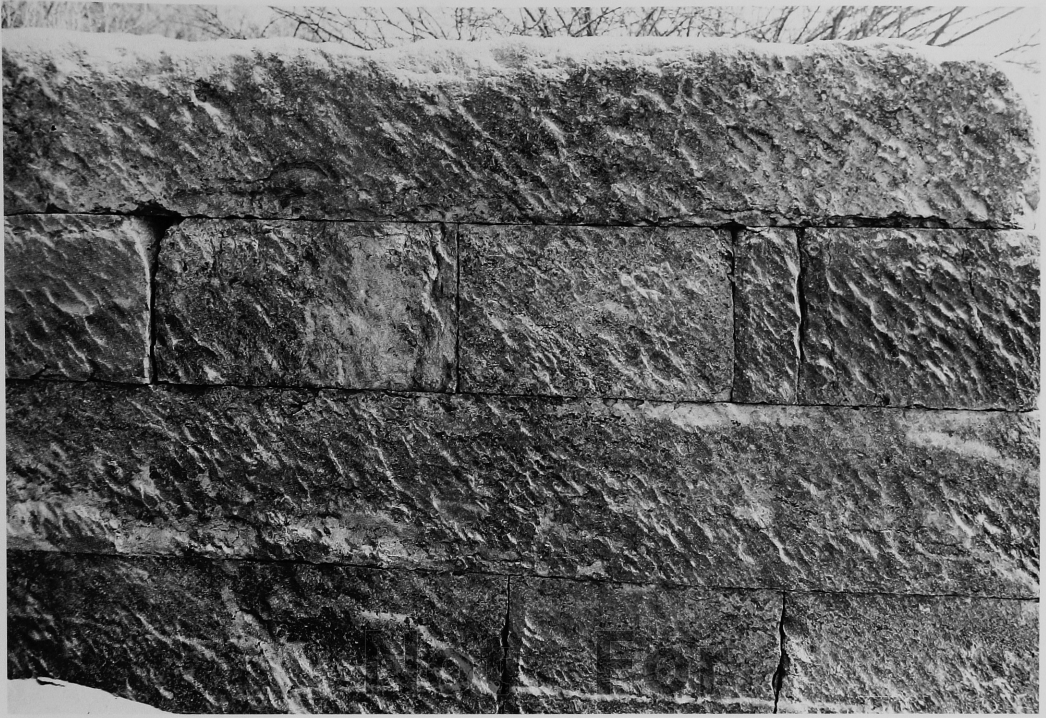
a. Wasserfacetten an der Auslässeite des Ostpfeilers der Anlage C; Fließrichtung: von links oben nach rechts unten.
